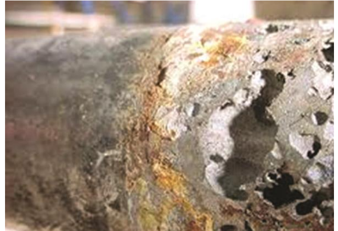
2. Ce sont les fosses. Cette image montre une pénétration importante suite à la corrosion par piqûre dans un tuyau en acier inoxydable. Gracieuseté de Huntingdon Fusion Techniques HFT
