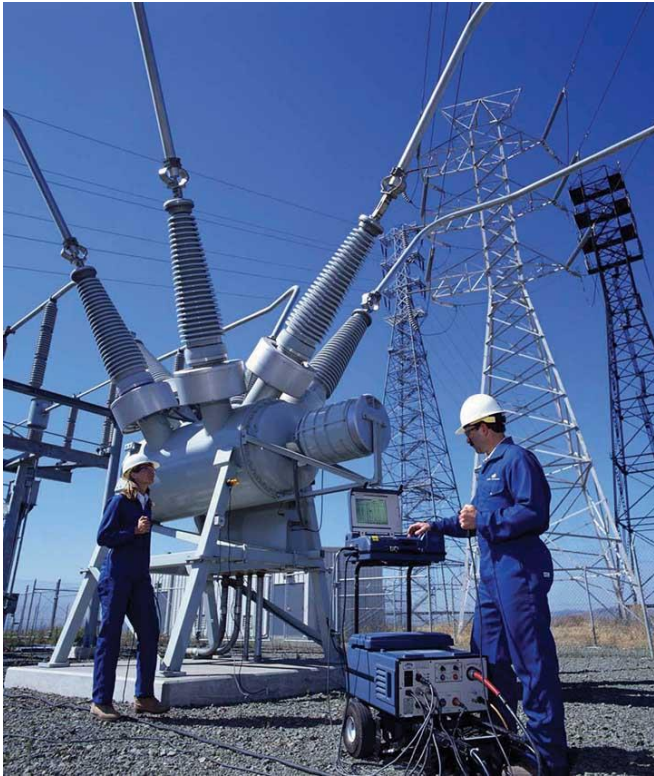
1. Les tests électriques impliquent plus que le simple raccordement de l'équipement de test et l'enregistrement des données; des techniciens expérimentés examinent attentivement les composants pour détecter tout signe de dommage, de détérioration, d'usure excessive et / ou de surchauffe, et d'autres défauts. Gracietesté: Services de fiabilité électrique
